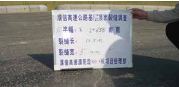
图 1 九标裂缝统计照片
